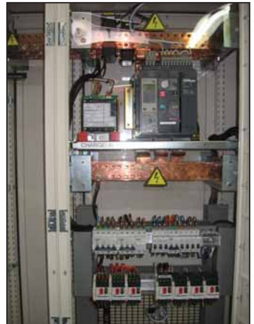
Détail d'une armoire de couplage de groupes électrogènes
