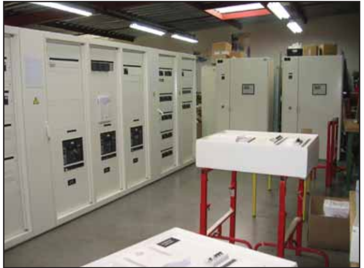
TGBT, armoires de couplage des groupes électrogènes, coffrets divisionnaires
