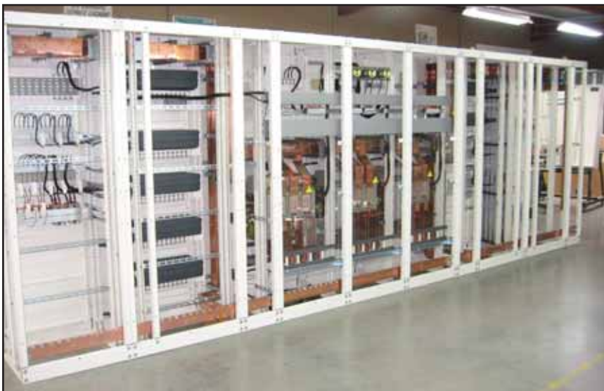
Vue arrière du TGBT, panneaux enlevés
