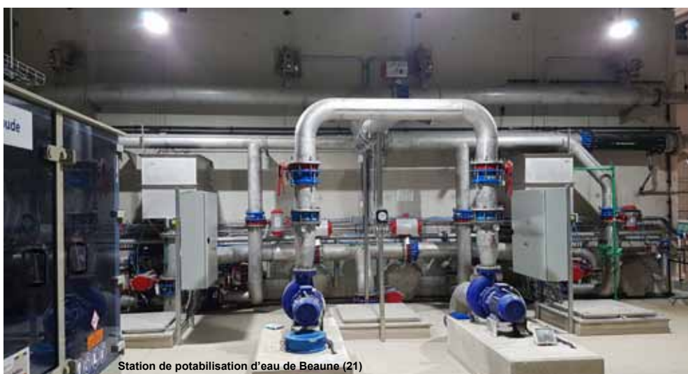
Station de potabilisation d'eau de Beaune (21)
