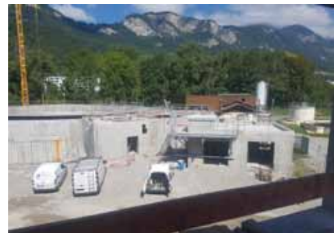
Station d'épuration de Bonneville
